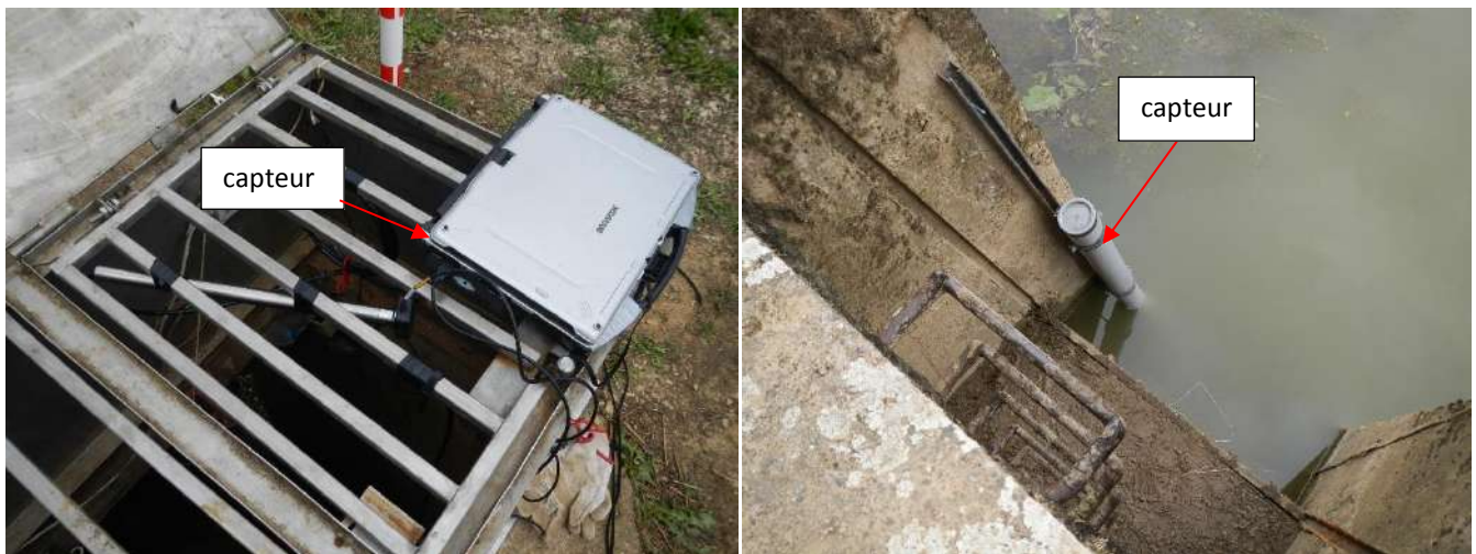
Instrumentation pendant l'essai de débit
