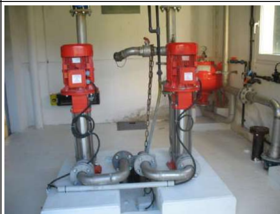
Pompes de reprise
